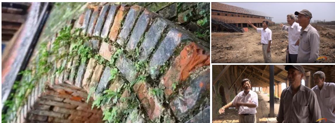
祝家甸砖窑底部的砖拱墙砌筑对施工提出较高的要求，邀请具备传统工艺技能的老匠人参与建造，达到较好建设效果 右图为曾经参与老砖窑建设的本地村民，被邀请参与到砖窑的改造更新中
